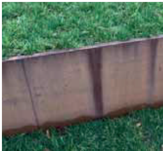
Unterschiedliche Farben durch Ablauf von Oberflächenwasser
