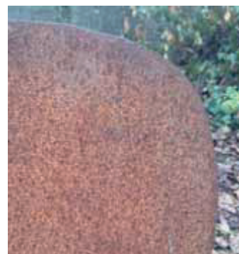
Beispiel für Cortenstahl nach mehr als drei Jahren Bewitterung
